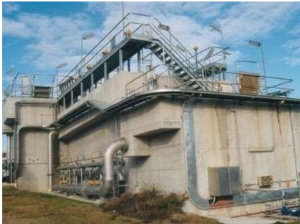
화학공장 파이프 COATING
